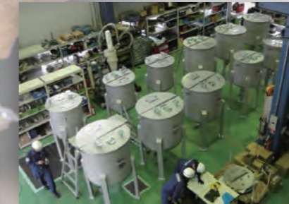
危険物貯蔵タンク SUS304 (消防検査時)
